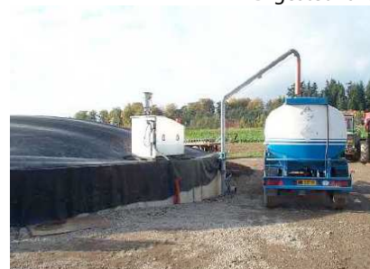
Extraction du digestat par pompage
