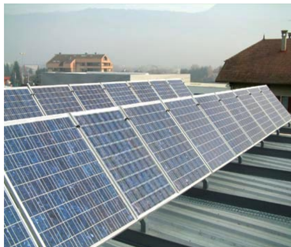
Vue rapprochée des capteurs
